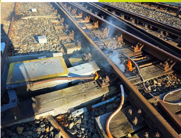
POŽÁR ELEKTROINSTALACE NA ZHLAVÍ DEPA HOSTIVAŘ, 26. 12. 2025
