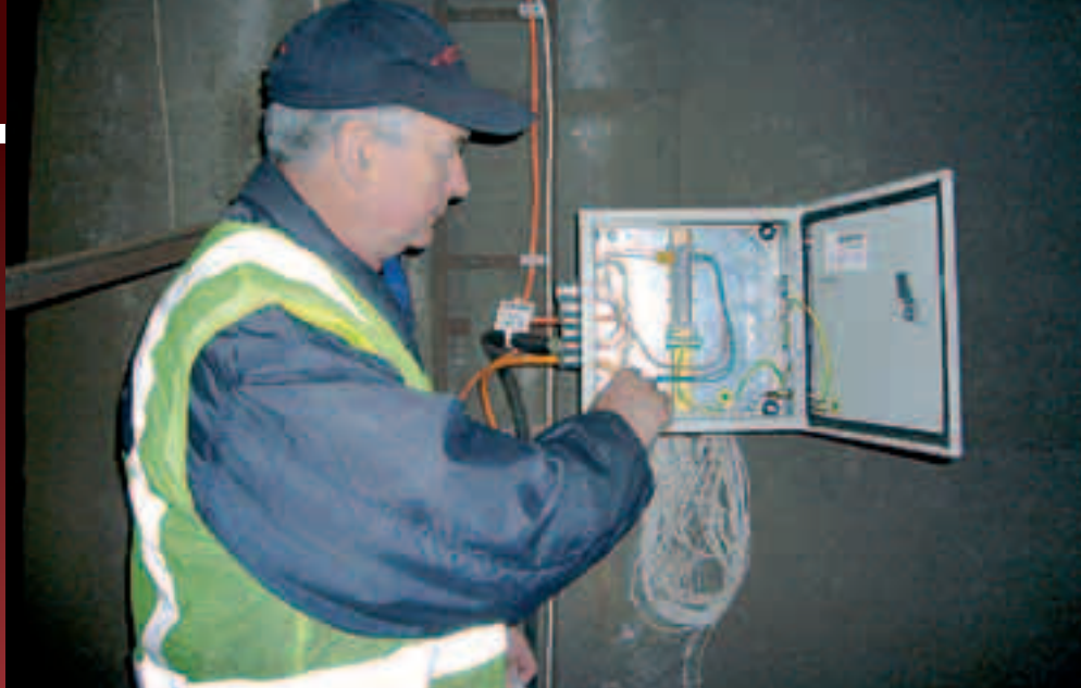
Kontrolní měřicí objekt v tunelu metra.
