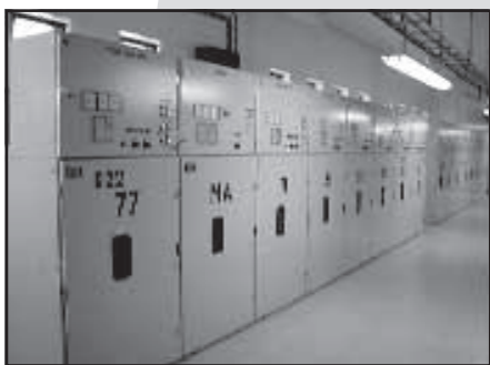
Napáječový rozváděč +825 V elektrické stanice Černý Most.
