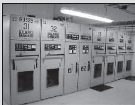
Rozváděč 22 kV elektrické stanice Černý Most.
