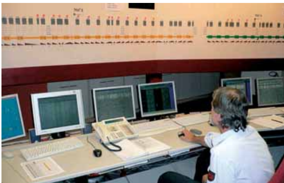
Na dispečinku se na přehledových schématech a monitorech sleduje provozní stav vybraných technologií ve stanicích metra. Ne všechny výtahy a plošiny mají automatický výstup sledování provozního stavu. Dispečink v těchto případech dostává telefonické upozornění od dopravního personálu stanice.
