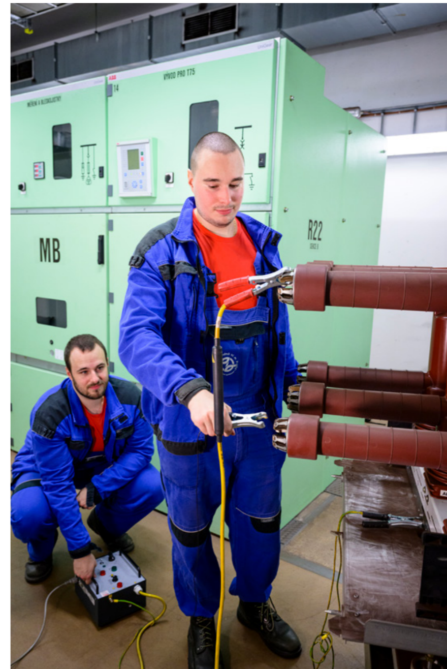
ZDE PROBÍHÁ S TZV. VIDAREM MĚŘENÍ VYPÍNAČE VD4 PRO ROZVADĚČ 22 KV
