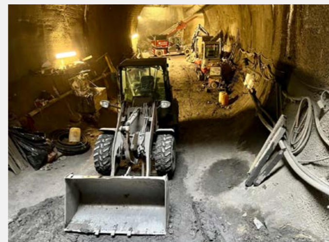
TO NENÍ STAVBA METRA D, ALE RAŽBY PRO BUDOUCÍ KASKÁDU VÝTAHŮ VE STANICI JIŘÍHO Z PODĚBRAD
