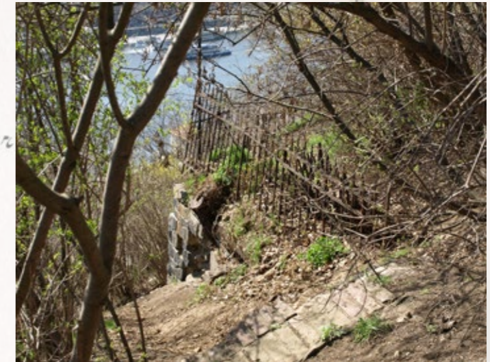
BĚHEM DVACETI LET, JEŽ UPLYNULY OD POŘÍZENÍ PŘEDCHOZÍHO SNÍMKU, SE TOHO MOC NEZMĚNILO. ZMIZEL JEN JEDEN VELKÝ STROM VYRŮSTAJÍCÍ Z OPĚRNÉ ZDI, KTERÁ HROZILA POD JEHO VÁHOU ZŘÍCENÍM
