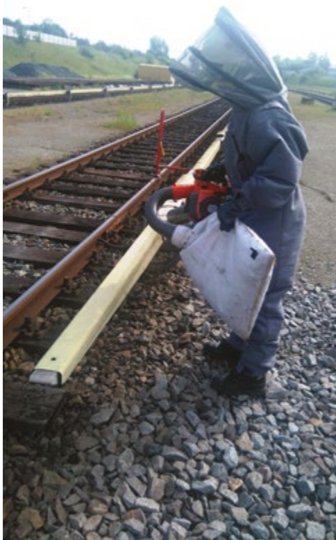
211. VÝJEZD, DEPO MĚTRA ZLIČÍN – TECHNICKÝ ZÁSAH ; VĚCÍ ROJ NA PŘÍVODNÍ KOLEJNICI: ZAJIŠTĚNO VYPNUTÍ A VYZKRATOVÁNÍ PK, ROJ ZLIKVIDOVÁN PŘENOSNÝM VYSAVAČEM, KOLEJNICE NASTŘÍKÁNA SPREJEM PROTI BODAVÉMU HMYZU. POUŽIT OCHRANNÝ ODĚV „SRŠEŇ XXL“
