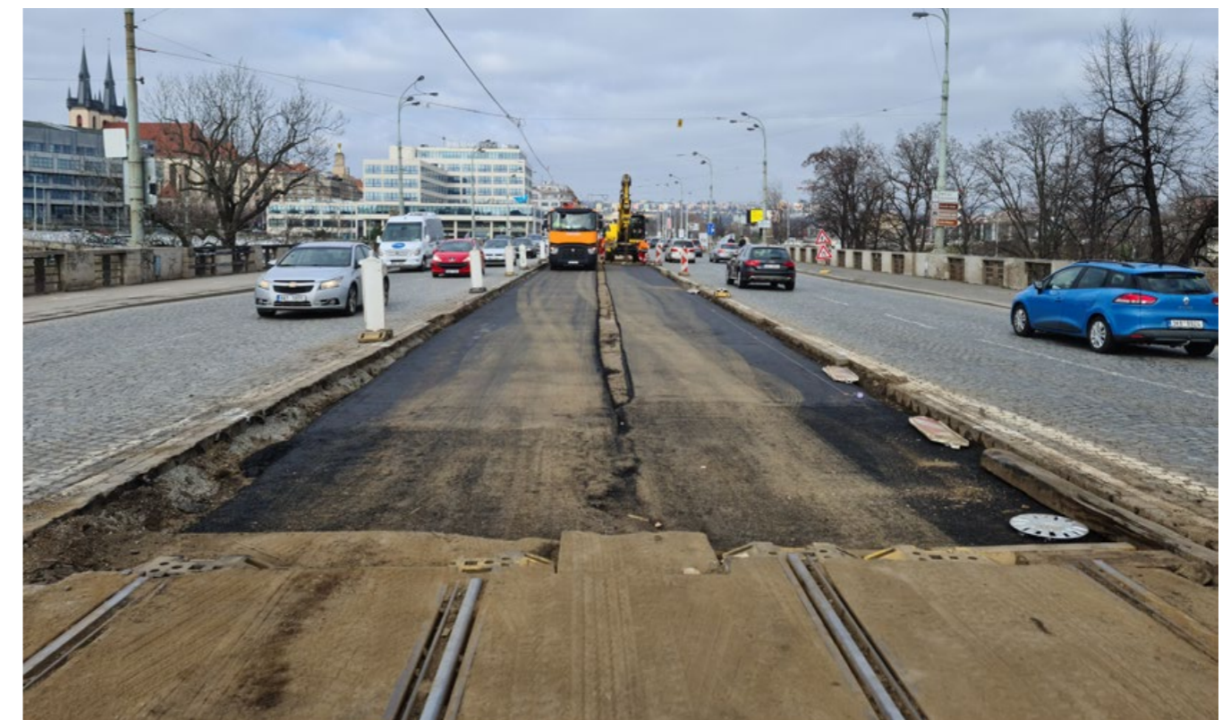
NA HLÁVKOVĚ MOSTĚ UŽ JE POLOŽENÁ ASFALTOVÁ LEPENKA. NA NI SE POKLÁDAJÍ PRVNÍ BKV PANELY. DO UKONČENÍ VÝLUKY V TUTO CHVÍLI ZBÝVALY TŘI TÝDNY
